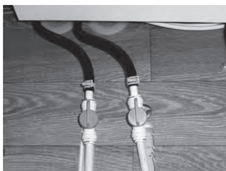
Ventiler i åben position
