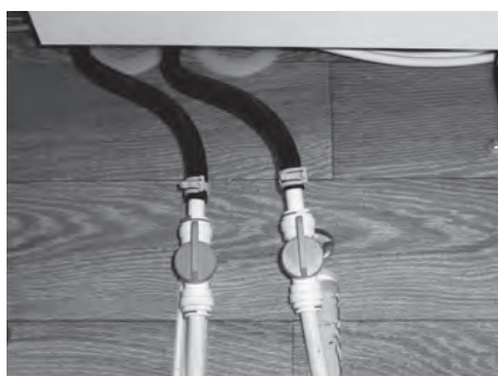
Ventiler i åben position
